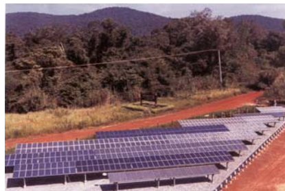
20 kWp, Sa Kaeo Province.
